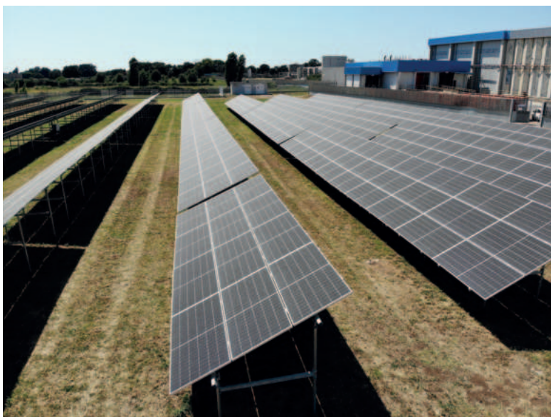
Impianto fotovoltaico presso il sito Findus di Cisterna di Latina
